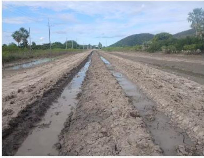
Las aguas retrocedieron en el camino Olimpo - Toro Pampa, solo falta cerrar los pequeños charcos de agua que aún queda.
