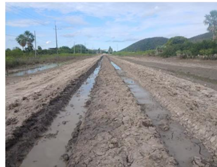
Las aguas retrocedieron en el camino Olimpo - Toro Pampa, solo falta cerrar los pequeños cortes de agua que aún quedan. Carlos Almeron
